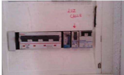
Imagen 9. Reloj convencional para encendido/apagado de la iluminación exterior
