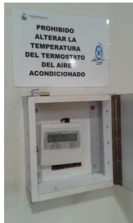
Imagen 12. Termostato del aire acondicionado del bloque viejo
